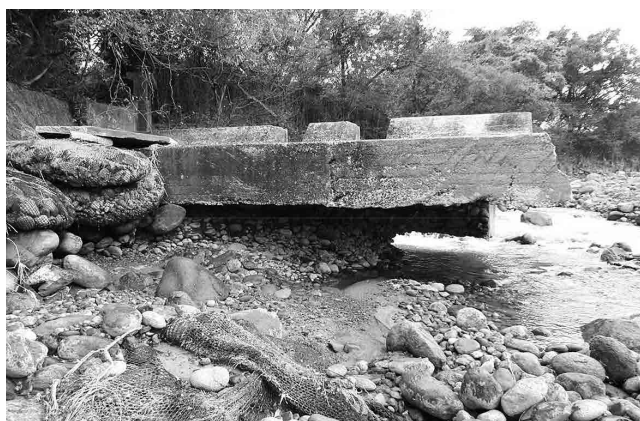
台風19号で被害を受けた新田堰
