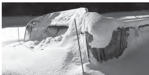
倒壊したパイプハウス
