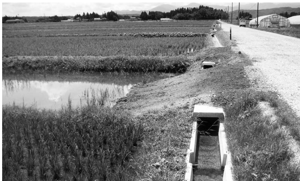
湿害発生箇所…工事が原因か？
