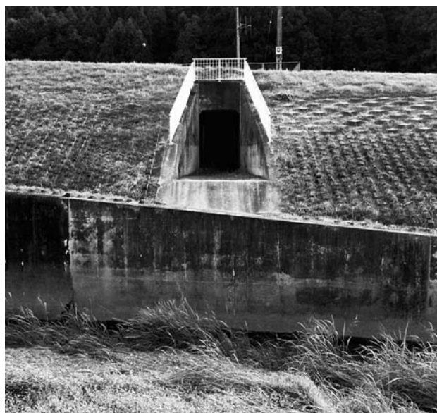
排水ポンプ取水口
