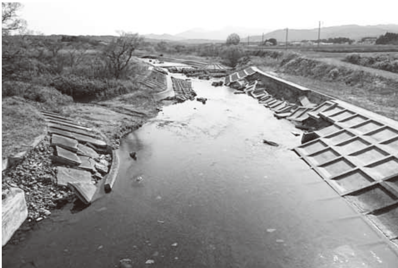
令和元年東日本台風の爪あと（花川護岸）
