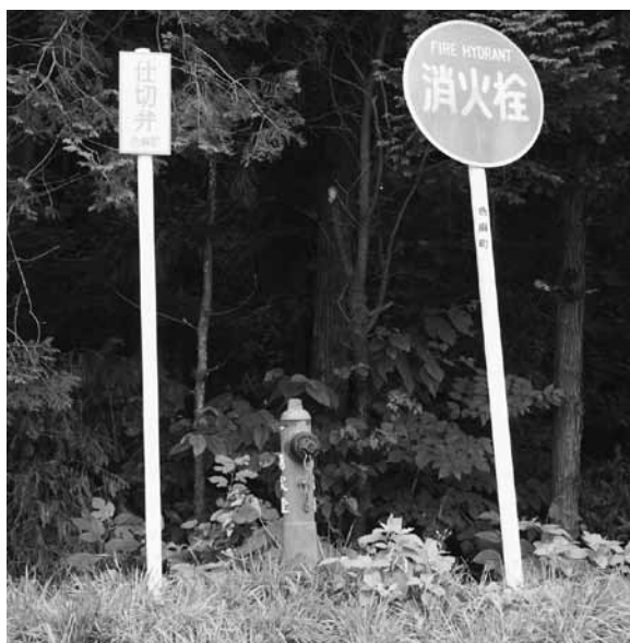
改善が必要な50mm管の消火栓
